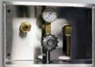
Livraisons facilitées par un accès 24 heures sur 24 aux postes de remplissage verrouillés inviolables sur site
